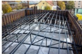
Die rüggig Einrahmen der Spundwände führt zu einer deutlichen Steigerung des Aufbaus. Die Verankerung der Spundwände erfolgt über die bereits vorhandene tragende Spundwand. Foto: Oliver Jäsi
