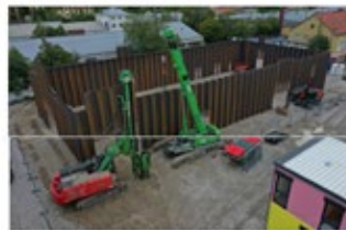
Die rüggig Einrahmen der Spundwände führt zu einer deutlichen Steigerung des Aufbaus. Die Verankerung der Spundwände erfolgt über die bereits vorhandene tragende Spundwand. Foto: Oliver Jäsi
